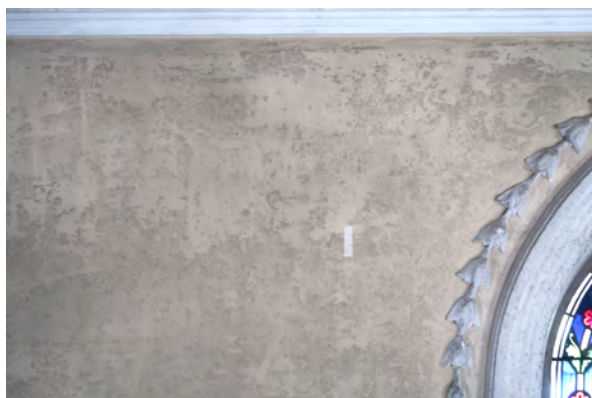
Wandfläche Kirchenschiff (nach Trockenreinigung) mit starkem Vorkommen der Stockflecken und Verschmutzungen [Abb. IMG_11 Massnahmen]
