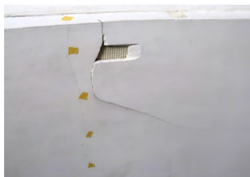
Rissstelle mit Ausbruch im Chorbogen | Bei der Putzloslösung wird das Armierungsgewebe (modern) sichtbar [IMG_21, Massnahmen]
