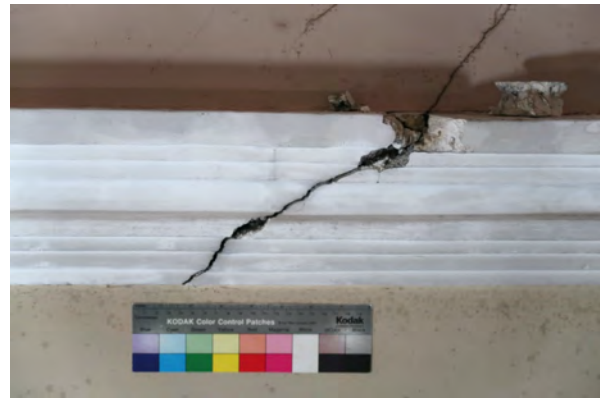
Detail Abb. links; Riss mit Versatz und Ausbruch Seitenaltars [Abb. IMG_06 Massnahmen]
