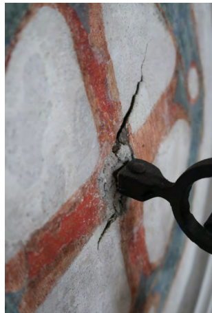
Detail Ausbruch, Lockerung/ Ablösung Putzgrund [IMG_129 Massnahmen]
