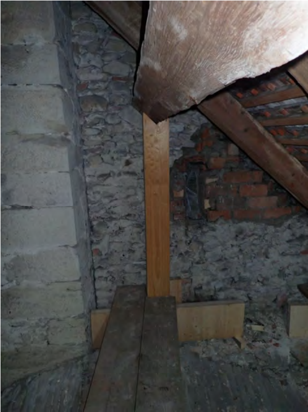
Abstützung Mittelpfette Sakristei
