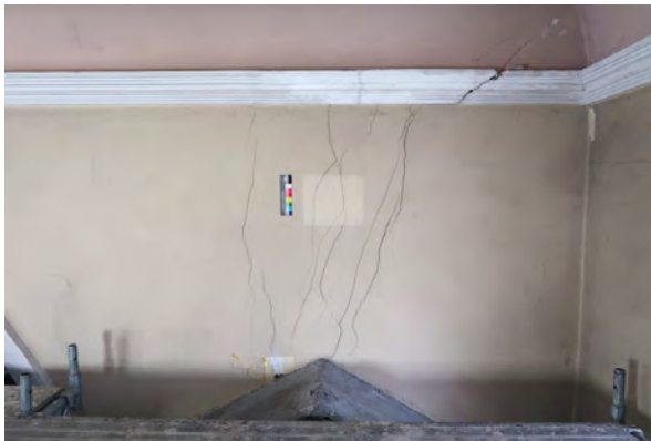
Chorwand (gegen Schiff) mit erheblicher Rissbildung oberhalb des rechten Seitenaltars [Abb. IMG_03 Massnahmen]
