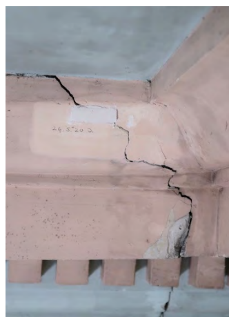
Rissmarke am Zahnschnittgesimse [Abb. IMG_18 Massnahmen]
