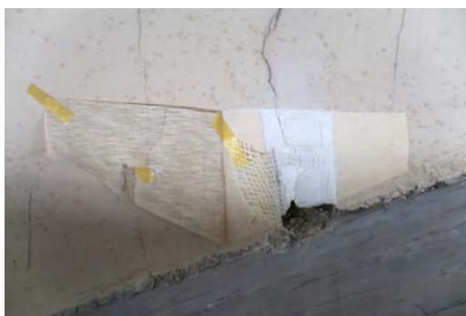
frühere Rissanierungsmassnahmen mit Kunststoffgeweben [Chorwand (zum Schiff) oberhalb Altar; IMG_05, Massnahmen]
