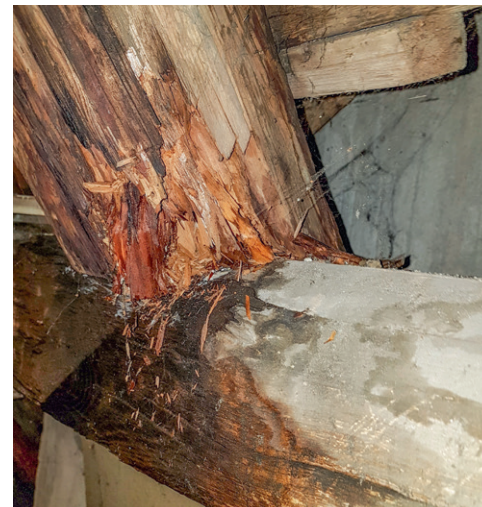
Eindringendes Wasser bei der Kehle zum Turm.
