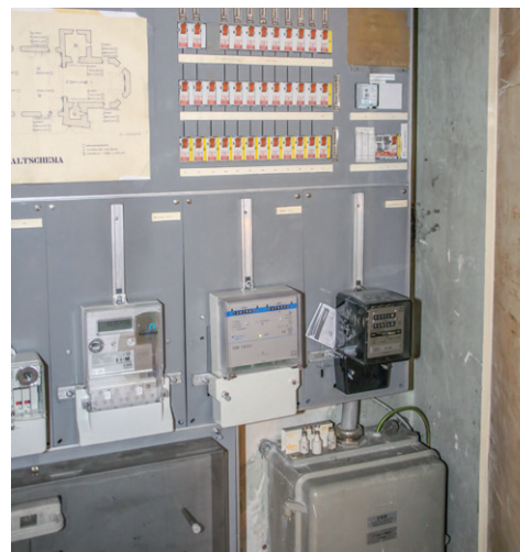
Veraltete Elektrohauptvertei- und Steuerungsanlage auf der Empore.
